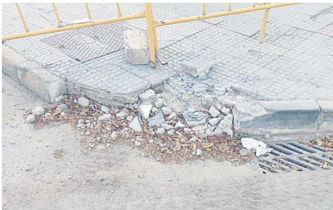
Uno de los desperfectos causados en el acerado por la maquinaria pesada.
